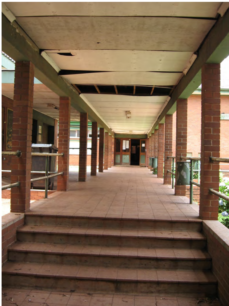
Etat de délabrement des bâtiments de ces écoles défavorisées, Novembre 2010, M. Jacobs
